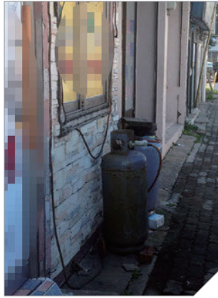
가스 연결호스가 과도하게 길게 설치된 경우
